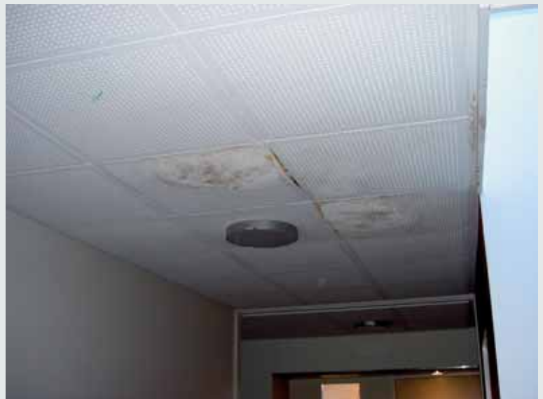
Vandgennemtrængning ved loftplader.
