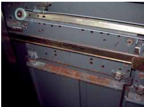
Rustdannelse på ophængnings-systemet for skaktdørene
